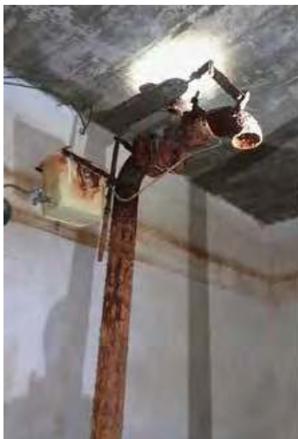
Alimentation réservoir de Soudon avant/après
